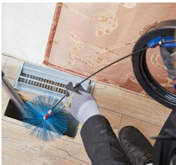
清洗地送风管道
